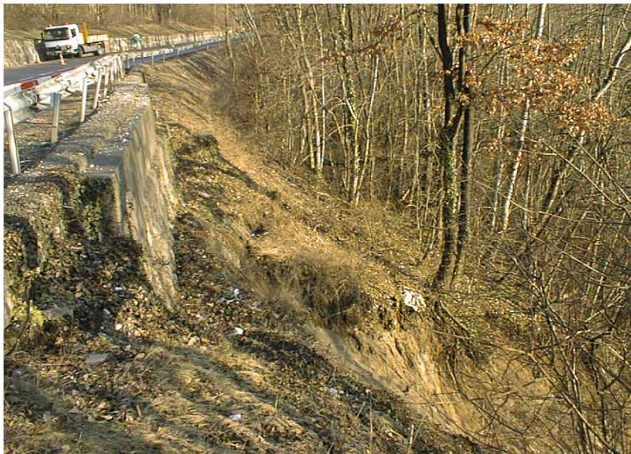
Glissement de terrain au toit de la molasse (PR 1+870).
