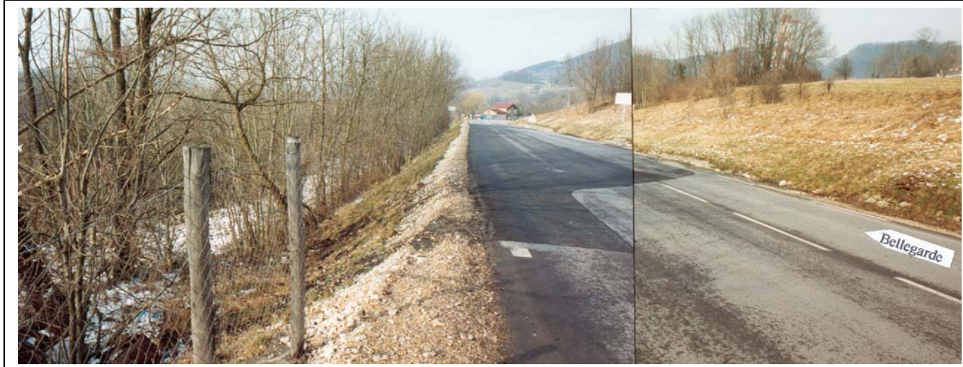
Glissement de terrain de « sous-Vanchy » (PR 2+200).
