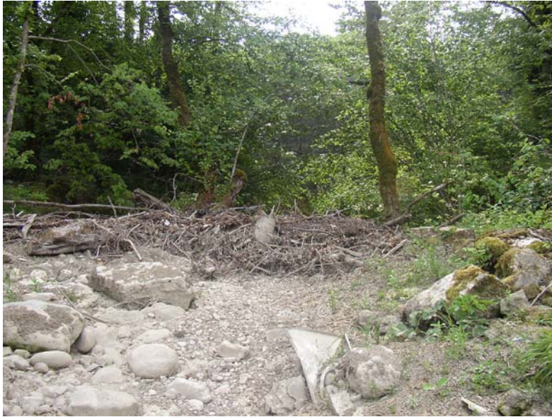
Embâcles dans le lit du ruisseau de la Fontaine des Malades en amont immédiat du pont de la RD25
