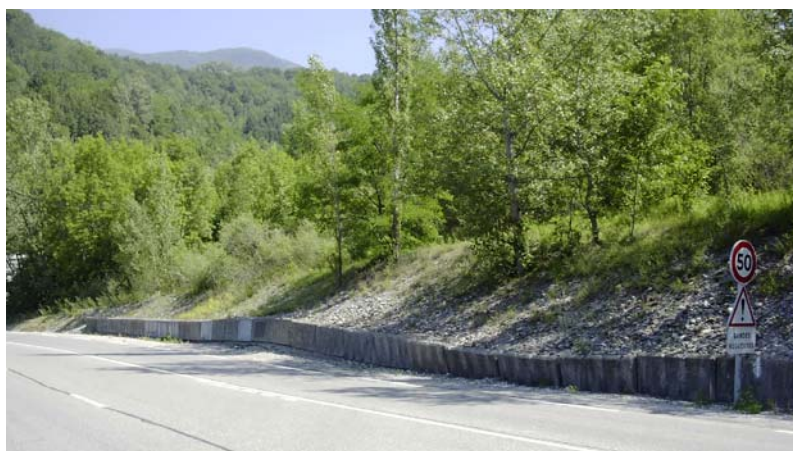
Glissement de terrain de « La Poterie » (PR 3+200). Glissement toujours actif même après le confortement
