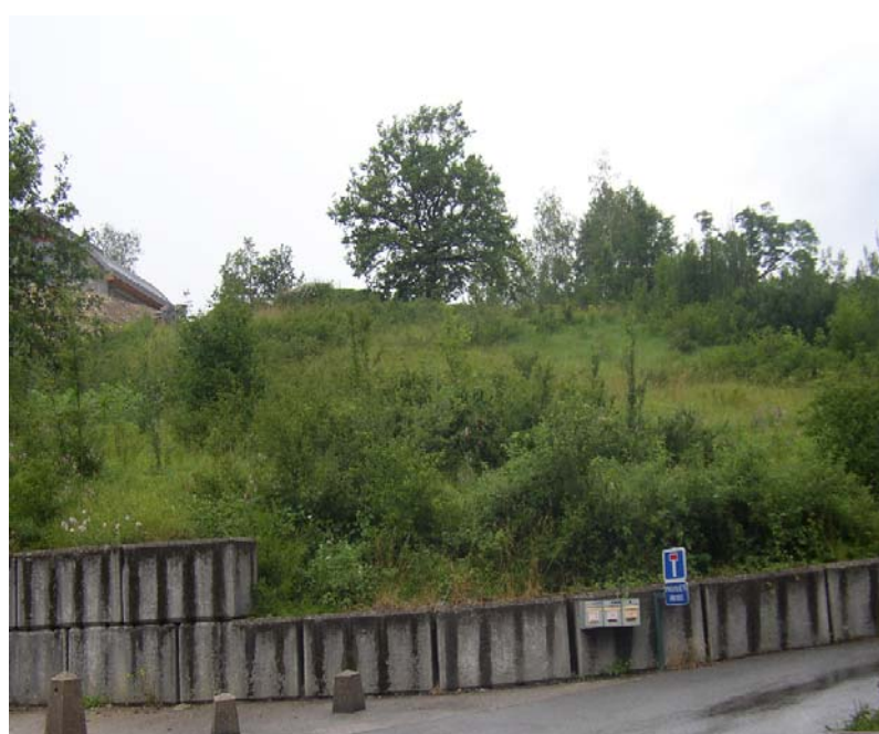
PHOTO B : Terrain situé en bordure de la route de Vouvray présentant des signes d'un glissement ancien
