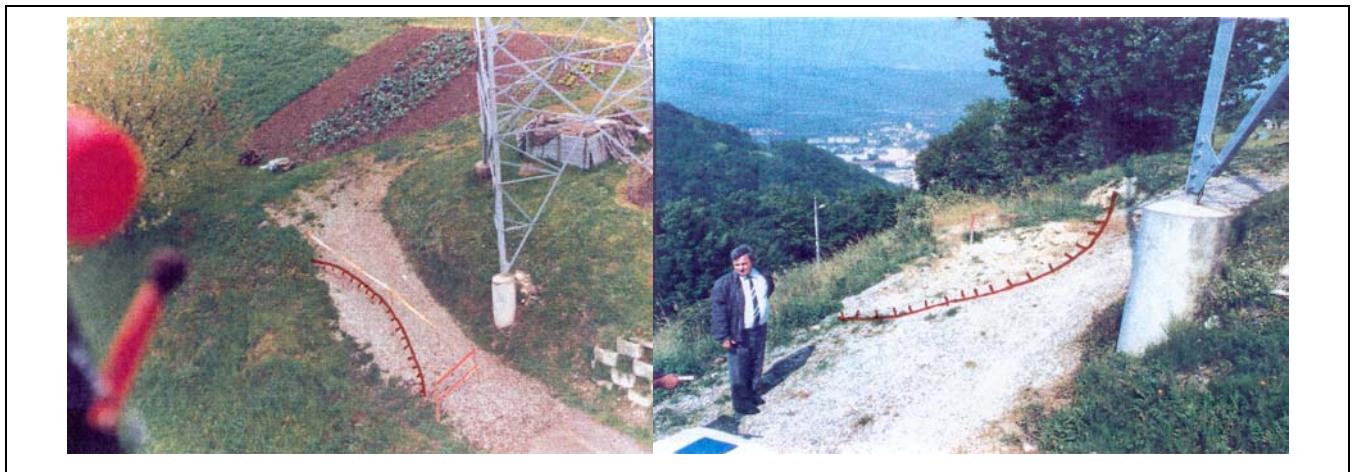
Glissement de terrain au droit du pylône EDF
